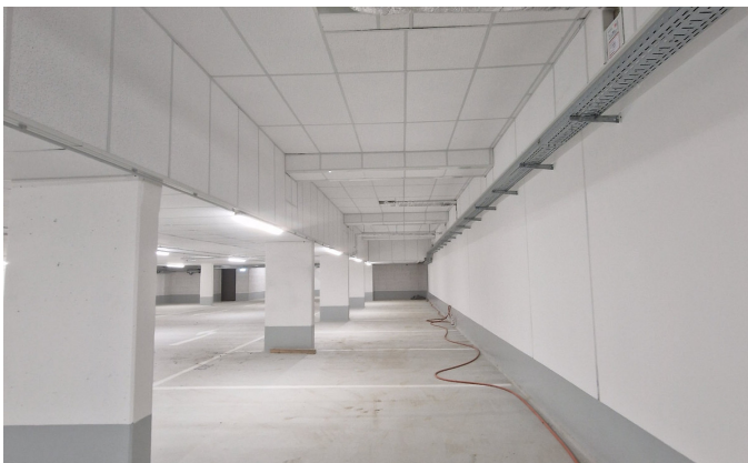
Deckenfläche im Fahrbereich
